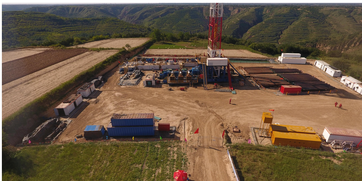
宁古 5 天然气井场航拍照片
