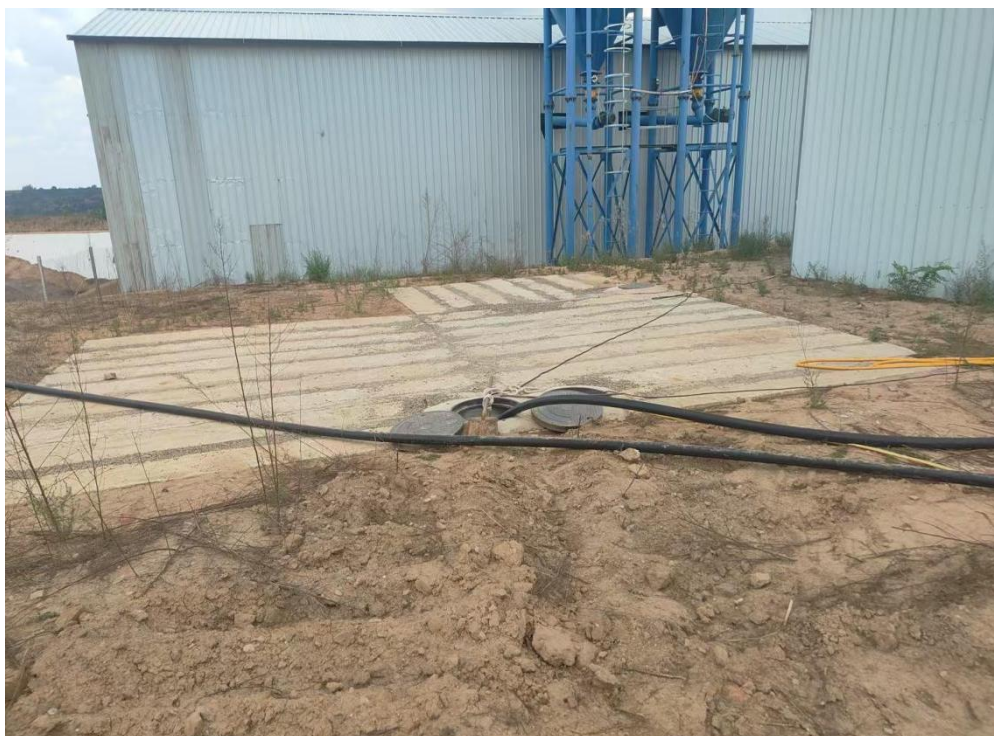
已建成雨污水处理池
